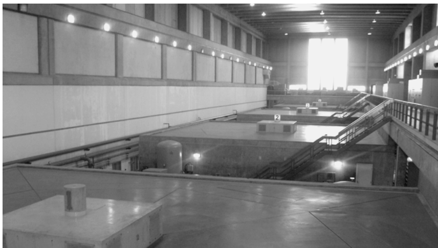
Гидротурбинные агрегаты на ГЭС в г. Кпоне.
