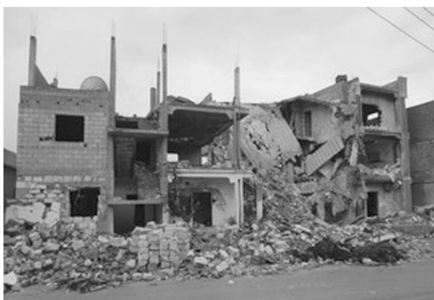
Разрушенные жилые дома в Ливии.
